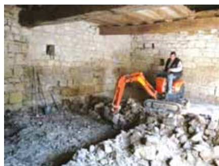
1/ Décaissement du sol existant en prenant soin de la périphérie des murs.
